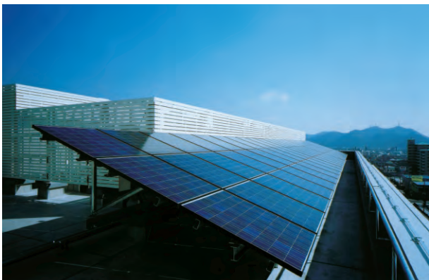
防災センターに設置された太陽電池パネル
