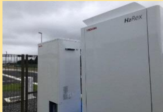
純水素型燃料電池コージェネレーションシステム(道の駅なみえ)
