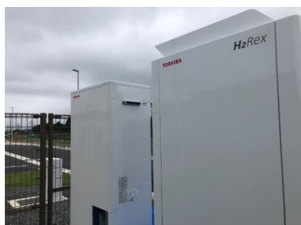
純水素型燃料電池 コージェネレーションシステム (道の駅なみえ)
