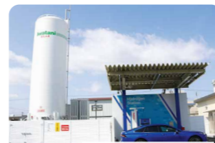
水素ステーション(姫路市)
