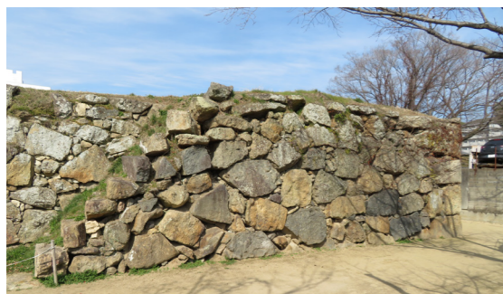
①【解体保存修理前】間詰石の脱落や築石のずれが目立ちます。写真や測量図など、修理前の記録を作成し、修理計画を立てます。
