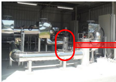
【紫外線処理設備】
