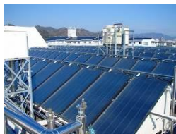
<太陽光発電（防災センター）>
