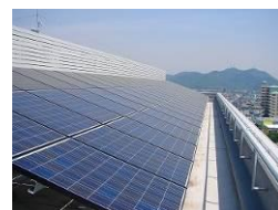
<太陽熱利用（総合スポーツ会館）>
