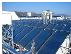
<太陽光発電（防災センター）>
