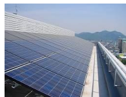
<太陽熱利用（総合スポーツ会館）>
