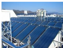
<太陽光発電（防災センター）>
