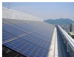
<太陽熱利用（総合スポーツ会館）>
