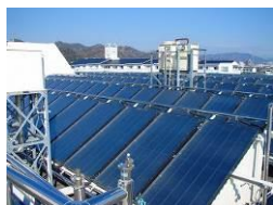
<太陽光発電（防災センター）>
