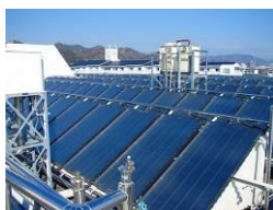
<太陽光発電（防災センター）>
