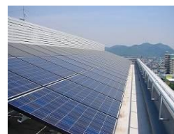
<太陽熱利用（総合スポーツ会館）>
